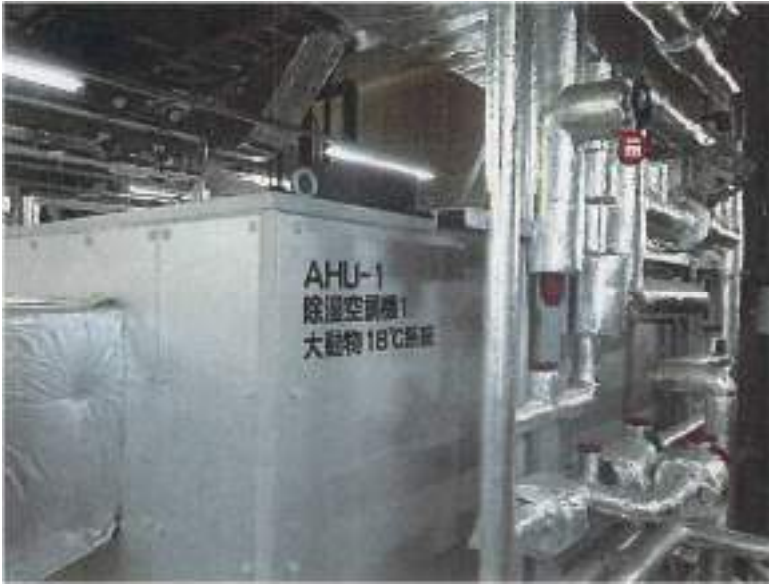
エアハンドリングユニット
