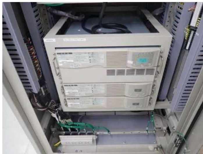
更新対象 UPS (鉄板無)
