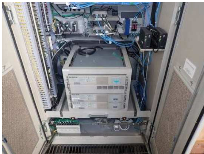
更新対象 UPS (鉄板有)
