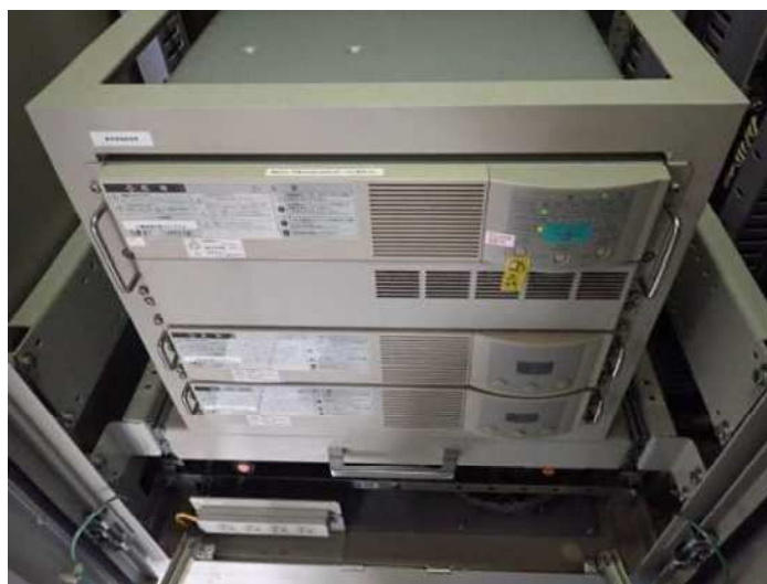
更新対象 UPS (鉄板有)
