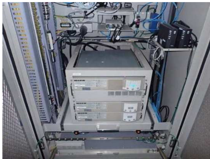
更新対象 UPS (鉄板有)
