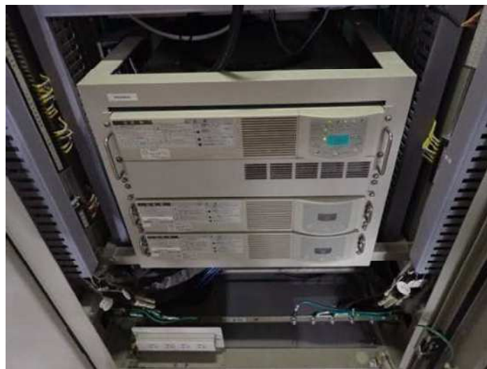
更新対象 UPS (鉄板無)
