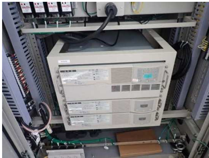
更新対象 UPS (鉄板無)
