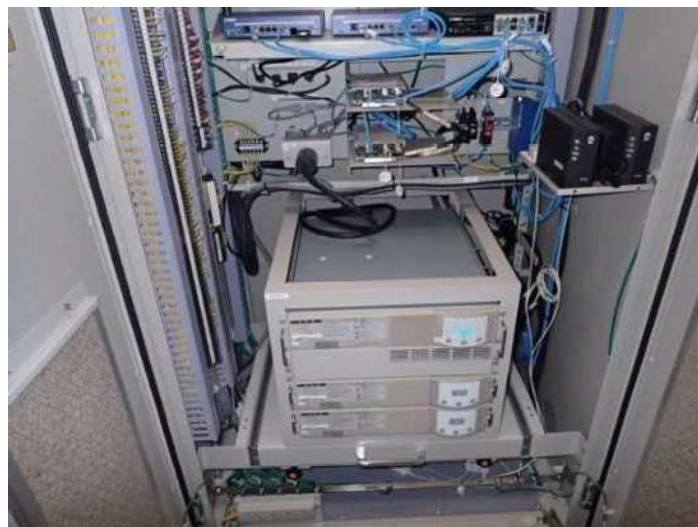
更新対象 UPS (鉄板有)
