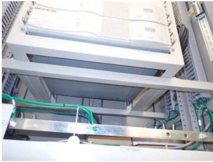
更新対象 UPS (下面)
