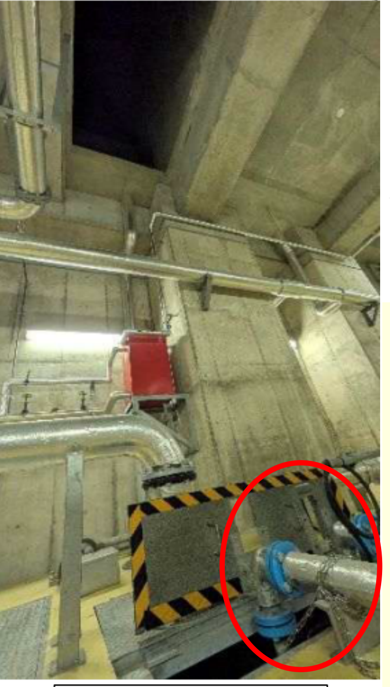
補給水ポンプ上部
