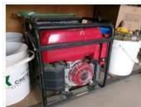
⑥発電機 (備品分)
