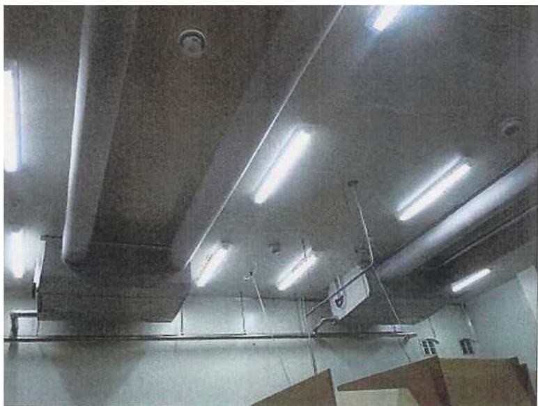
ソックダクト
