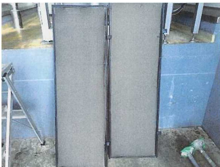
吸込み側フィルター
