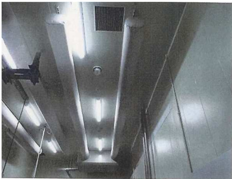
ソックダクト
