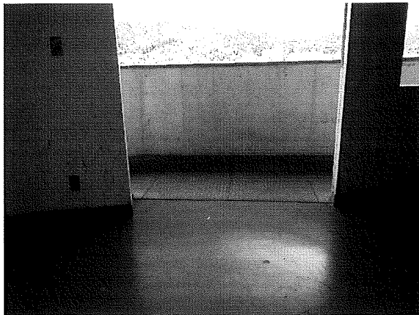
段差解消スロープ (参考写真)
