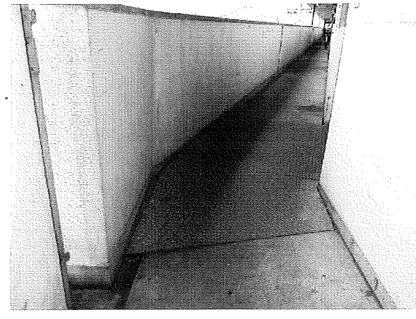
段差解消スロープ (参考写真)
