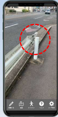
防護柵 の損傷
