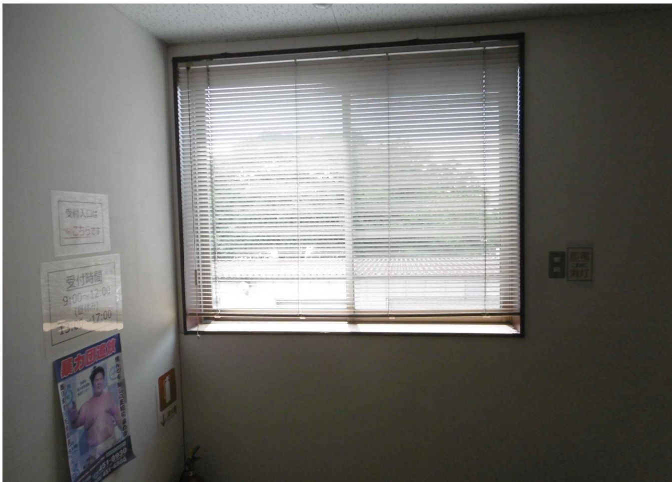
事務所棟（北棟）2階廊下西側開口部（1箇所）
