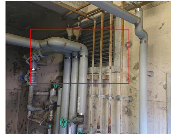
屋外ポンプ室 給水配管エルボ部分
