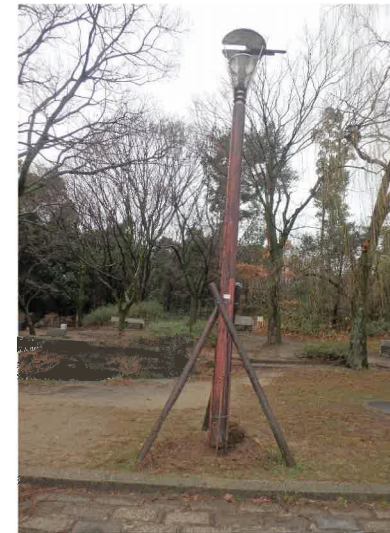
既存照明灯（撤去）
