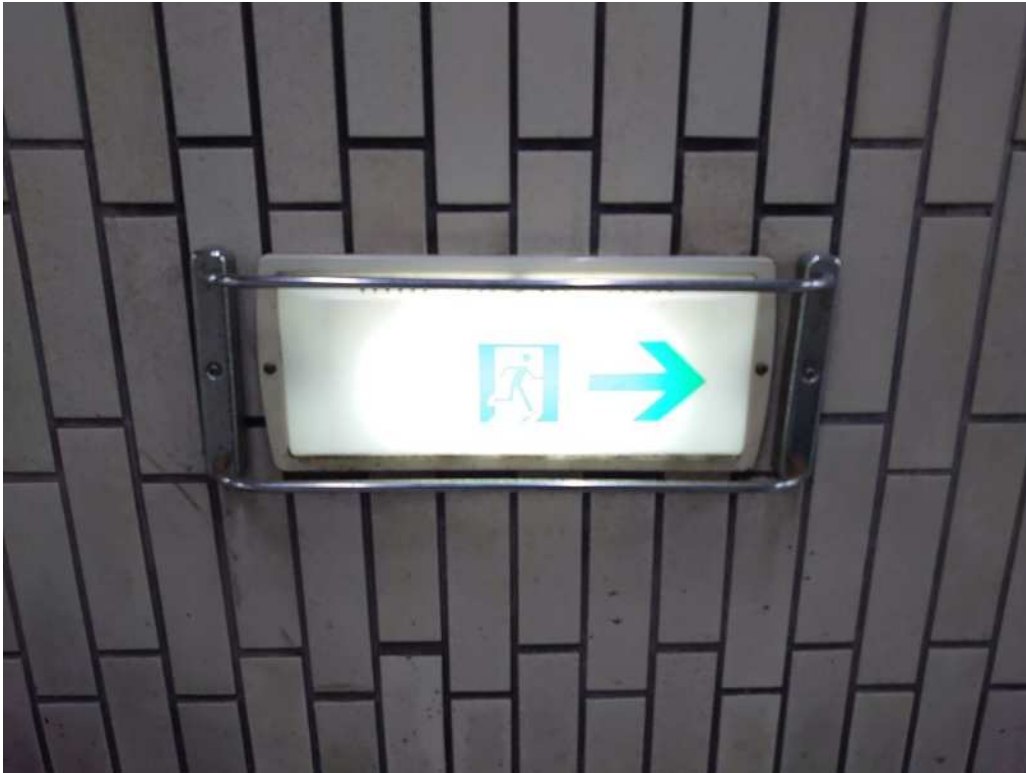
写真 3 : 既設 通路誘導灯 (中形)
