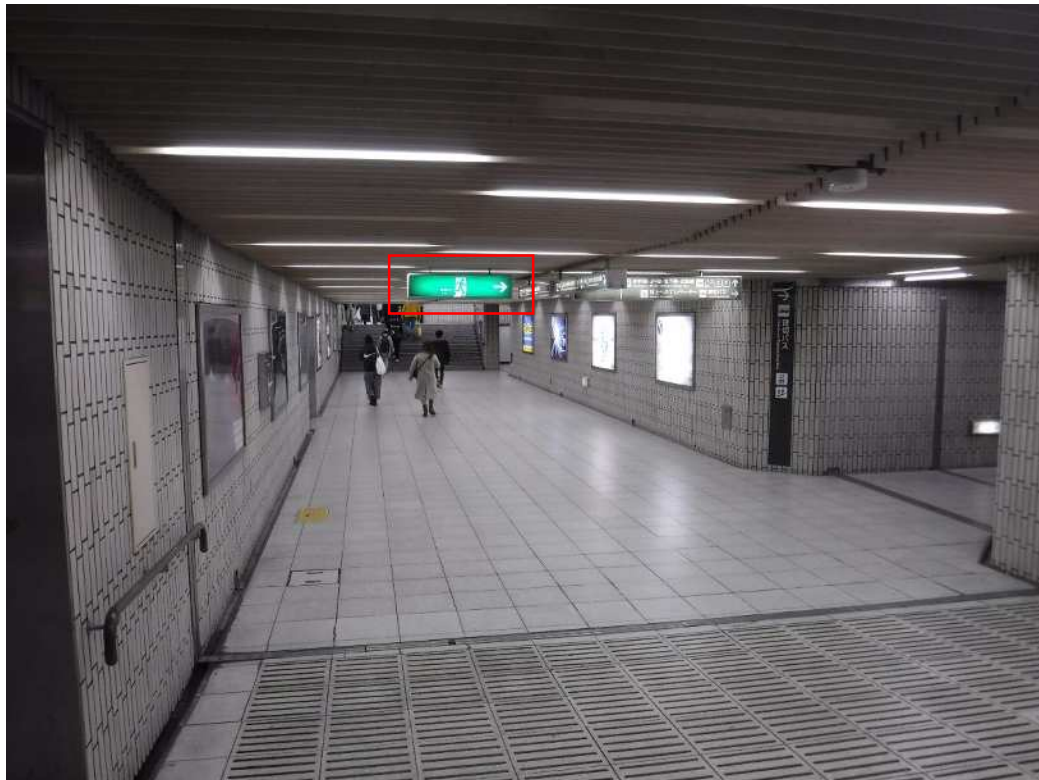
写真 1 : 避難口誘導灯 (大形)
