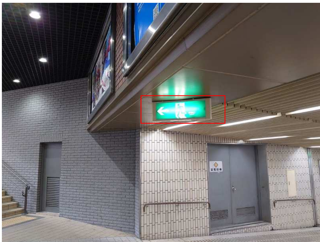
写真 2 : 避難口誘導灯 (BH 形)
