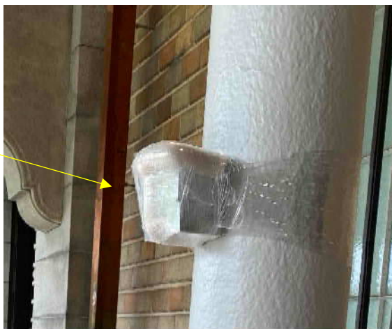
カバーを外した状態
