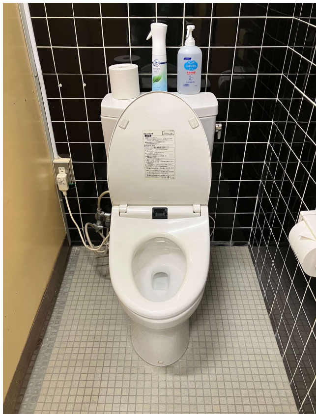
南部土木みどり事務所 1階浴室 床タイル破損
