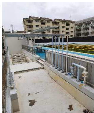
◇プールシャワー水漏れ(止水不良)
