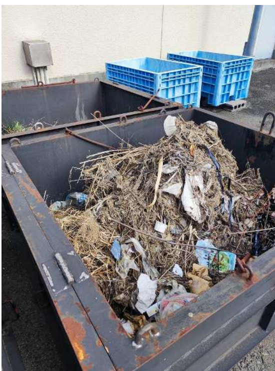
(新川排水機場 塵芥状況)
