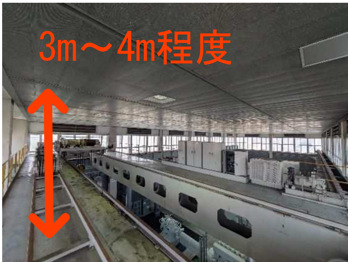
クレーン上部 1
