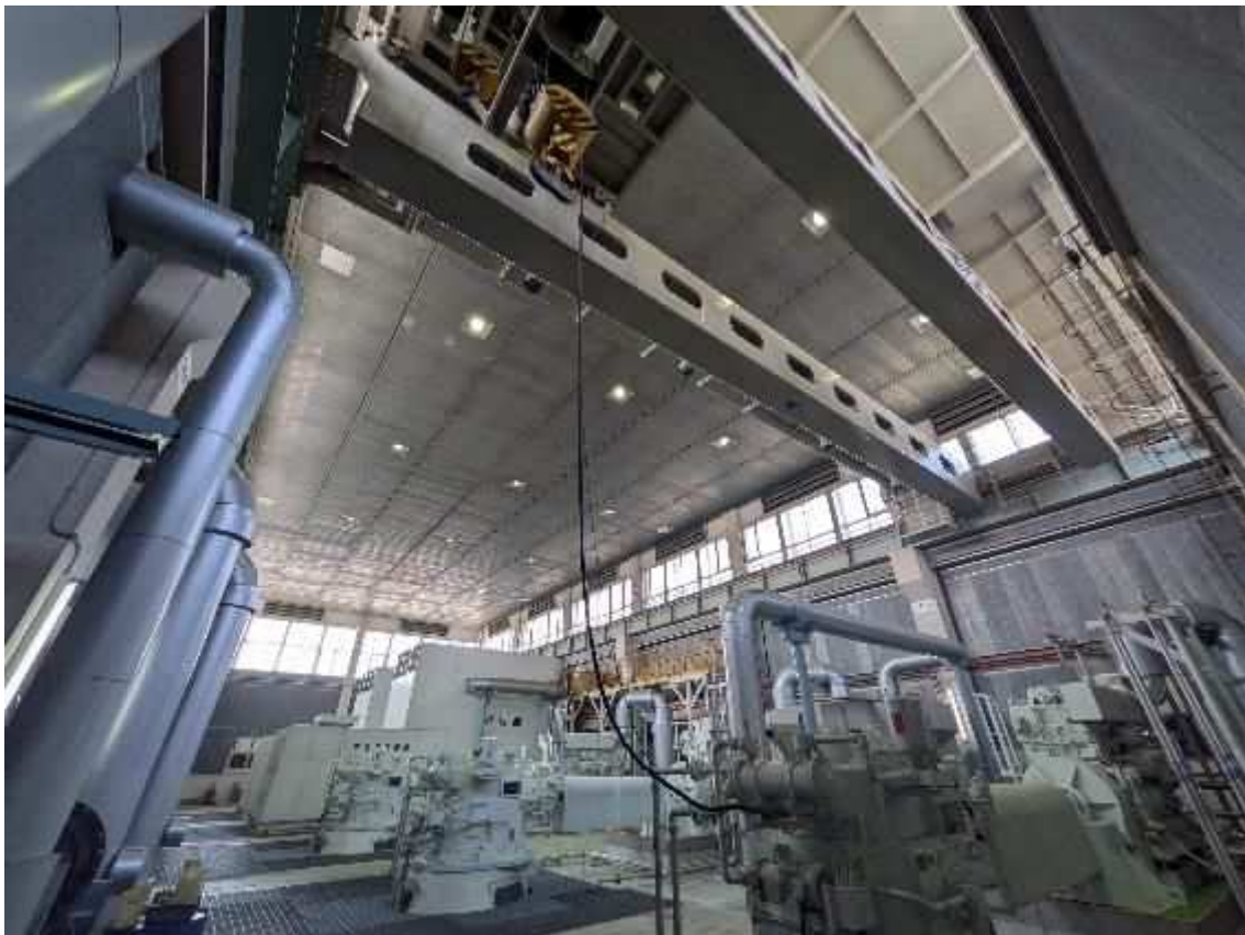
ポンプ室内北東
