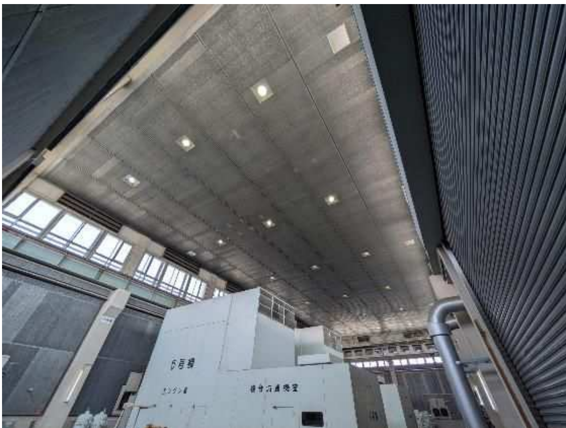
ポンプ室内南東
