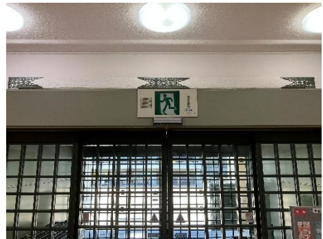
現在の避難誘導灯
