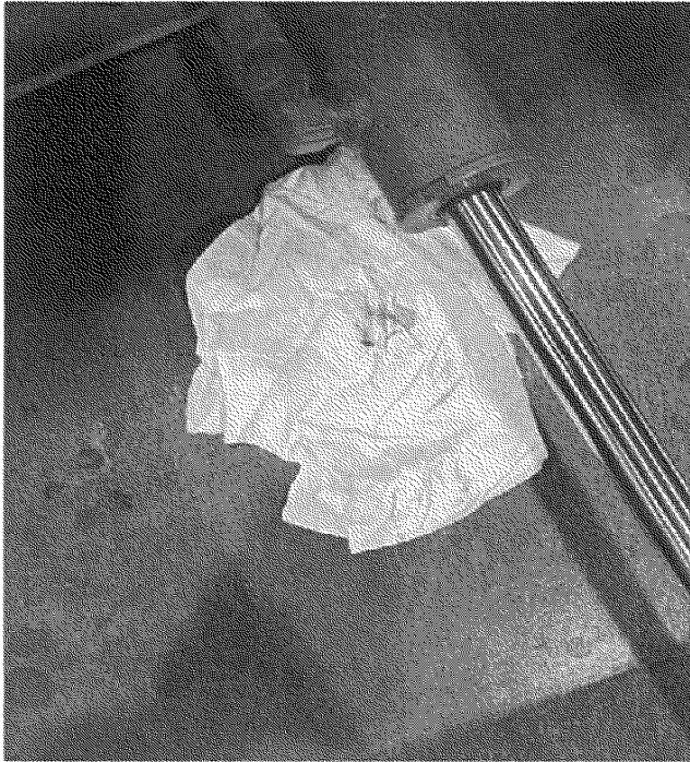
(1) リーチシリンダより油漏れ
