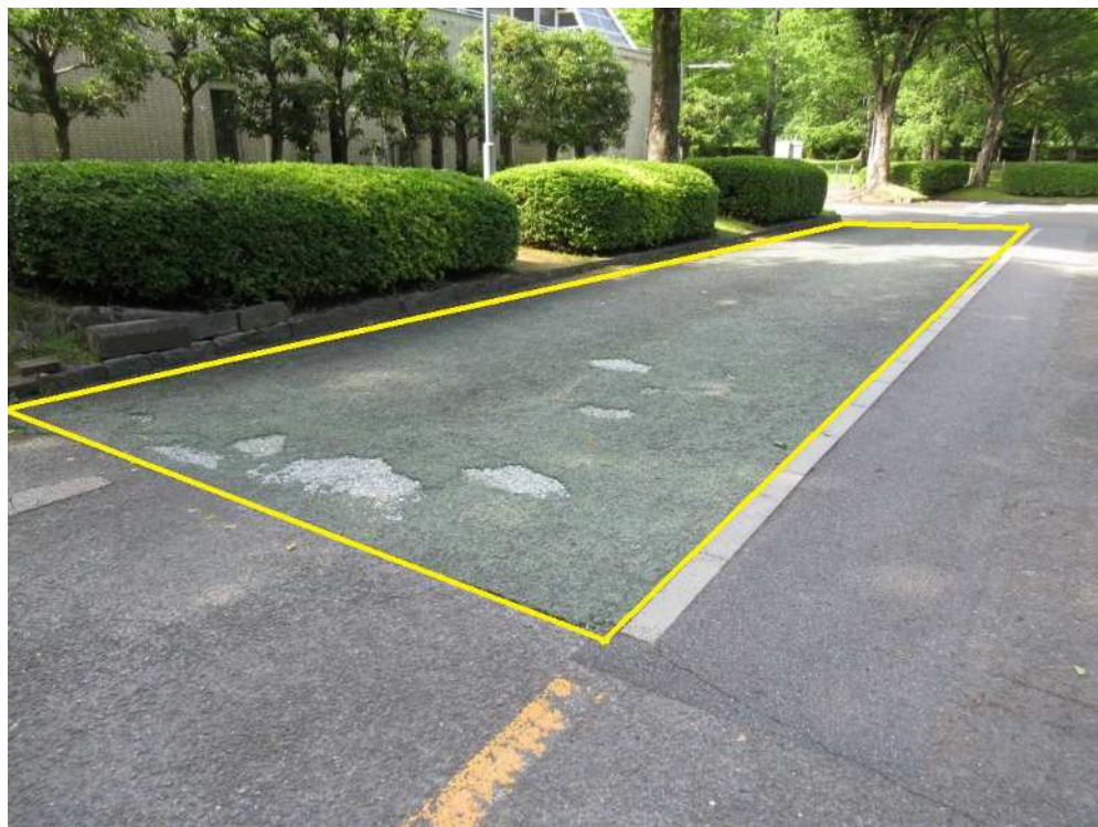
オーバーレイによるアスファルト塗装の盛り、めくれがある状態。
