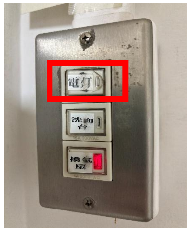
▲修繕対象スイッチ写真
