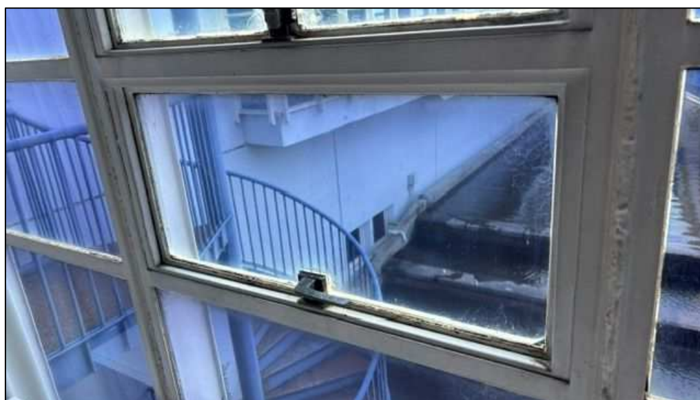
既存遮熱フィルム（クレセント付）
