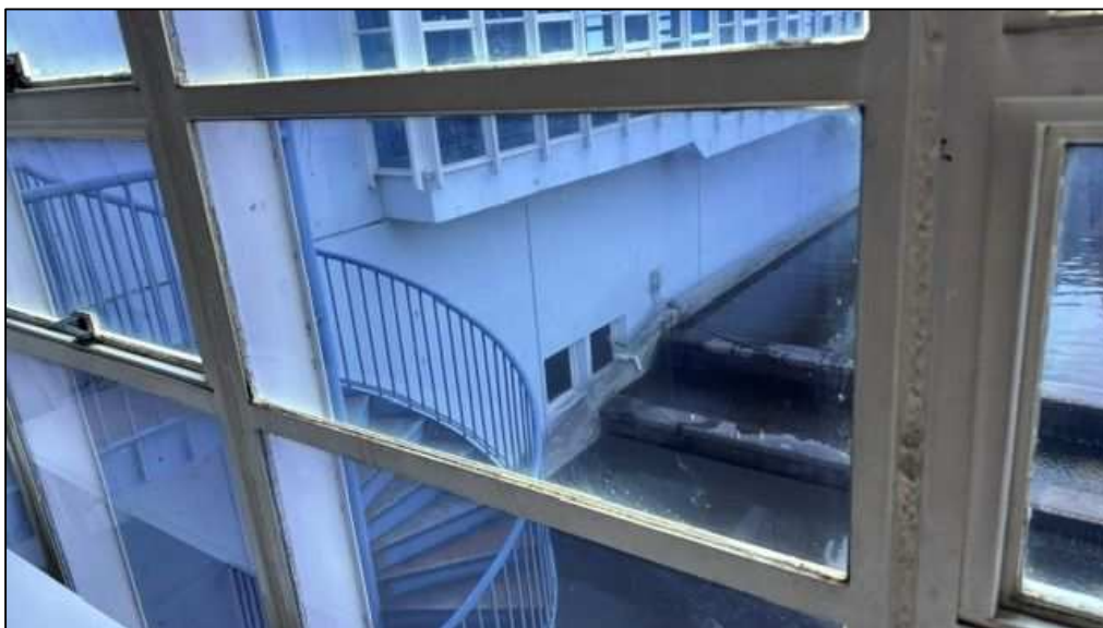
既存遮熱フィルム
