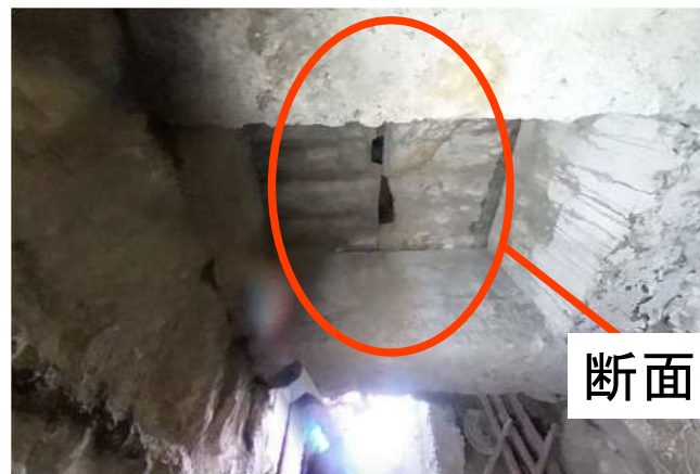
破損したコンクリート版箇所
