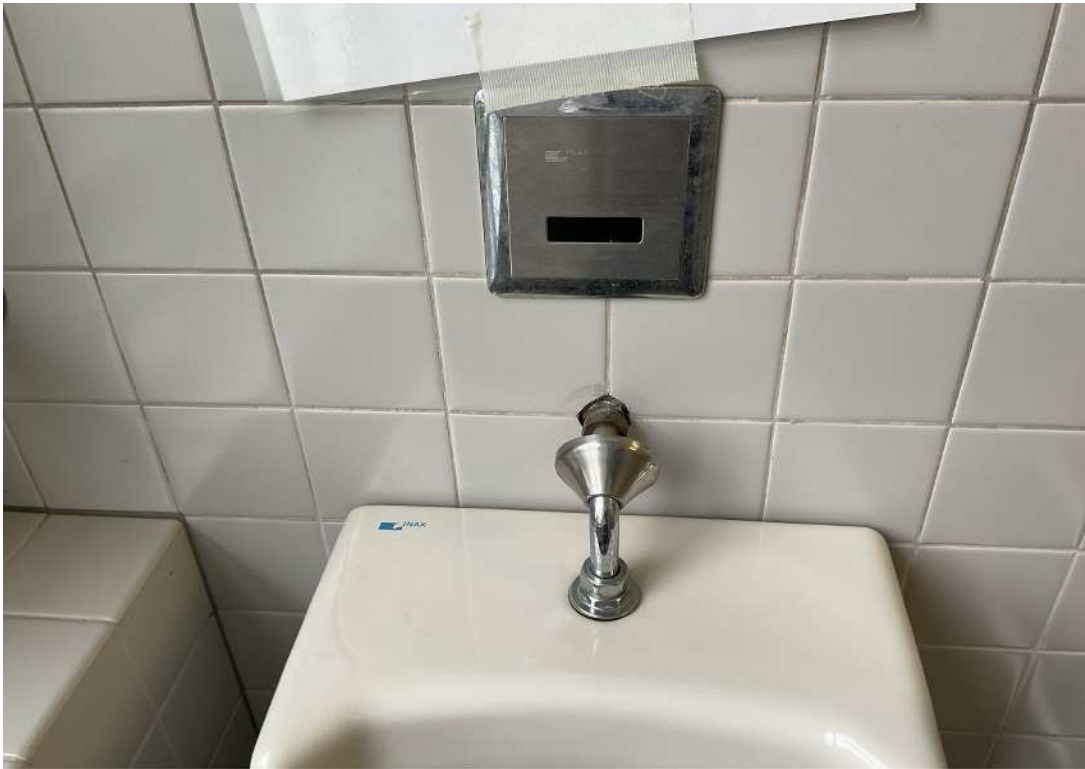
仕様書(別紙1)京都市立洛央小学校男子トイレ小便器センサー修繕
