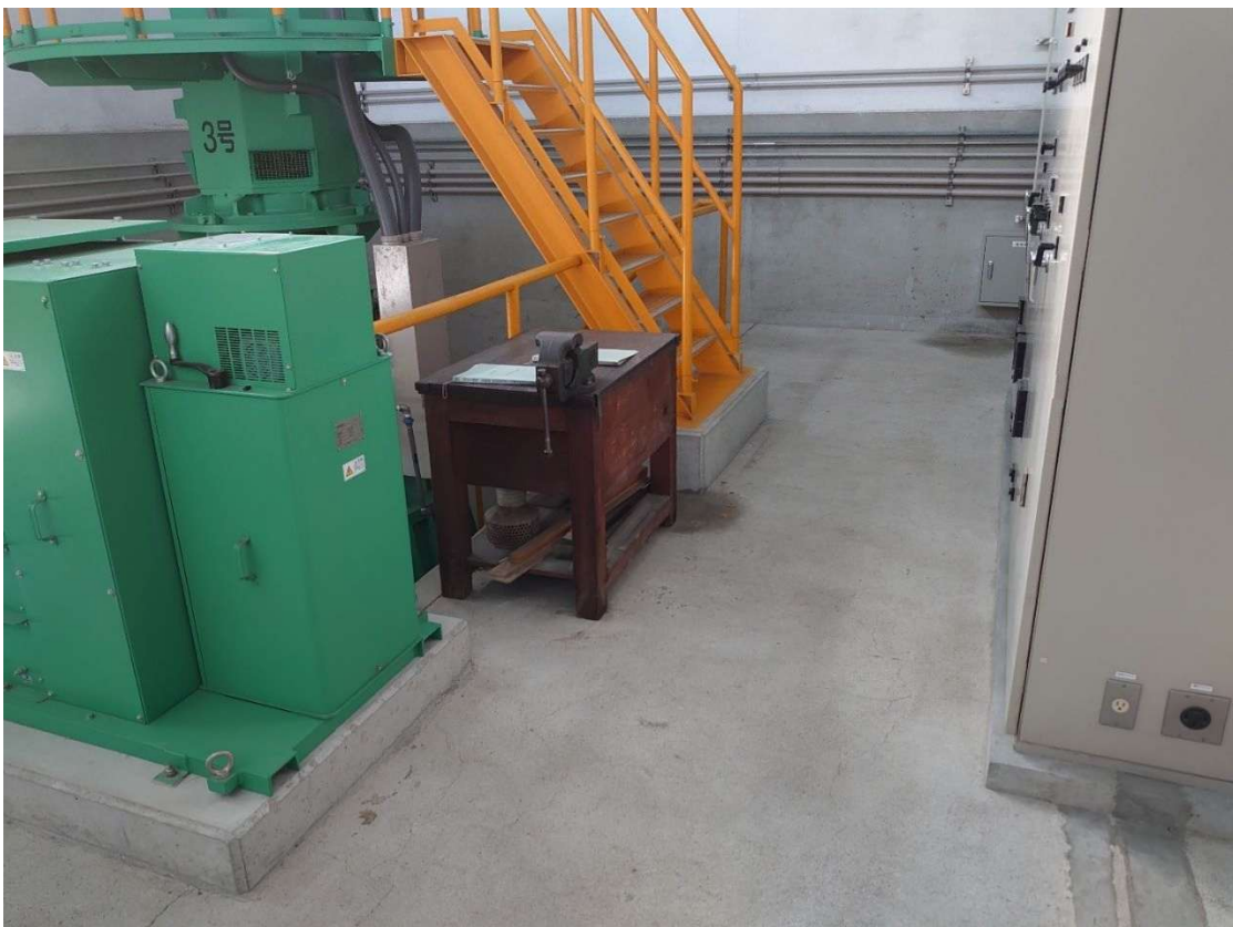
④ 受電盤前の状況
