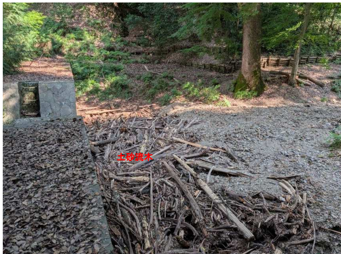
砂防堰堤土砂等堆積状況
