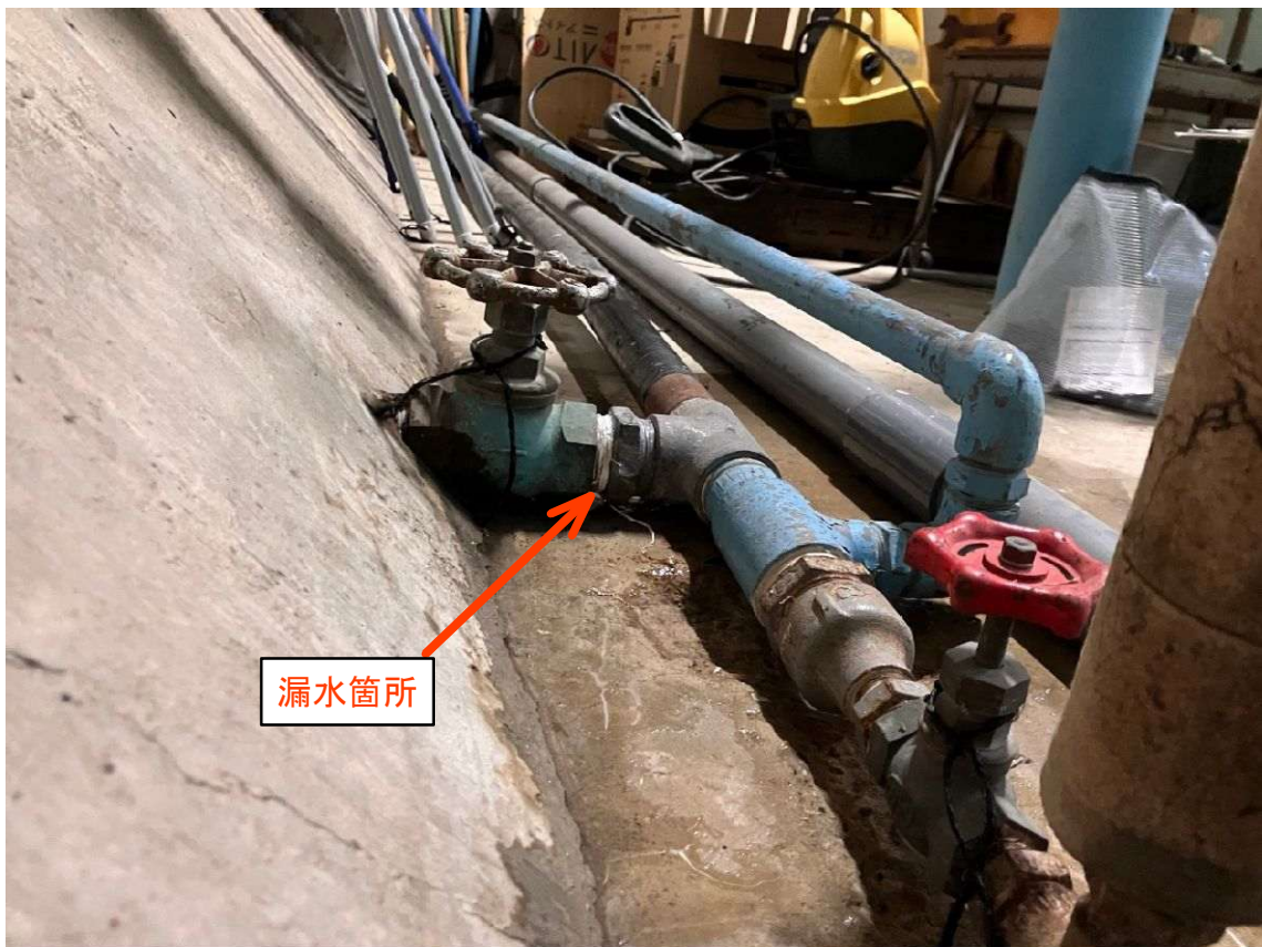
漏水箇所写真
