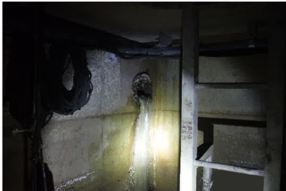
写真6：道路排水集水管
