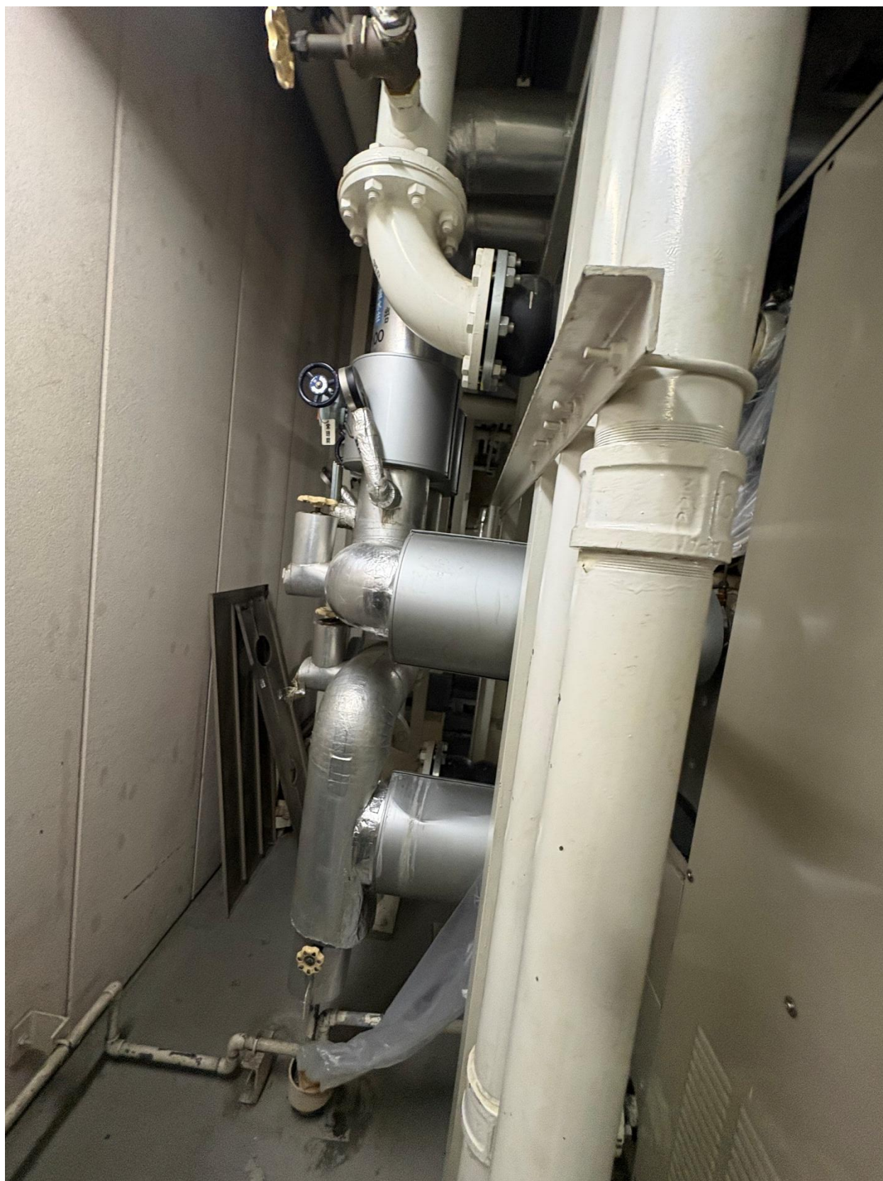
参考 2-2_冷温水管保温材 エルボ一部
