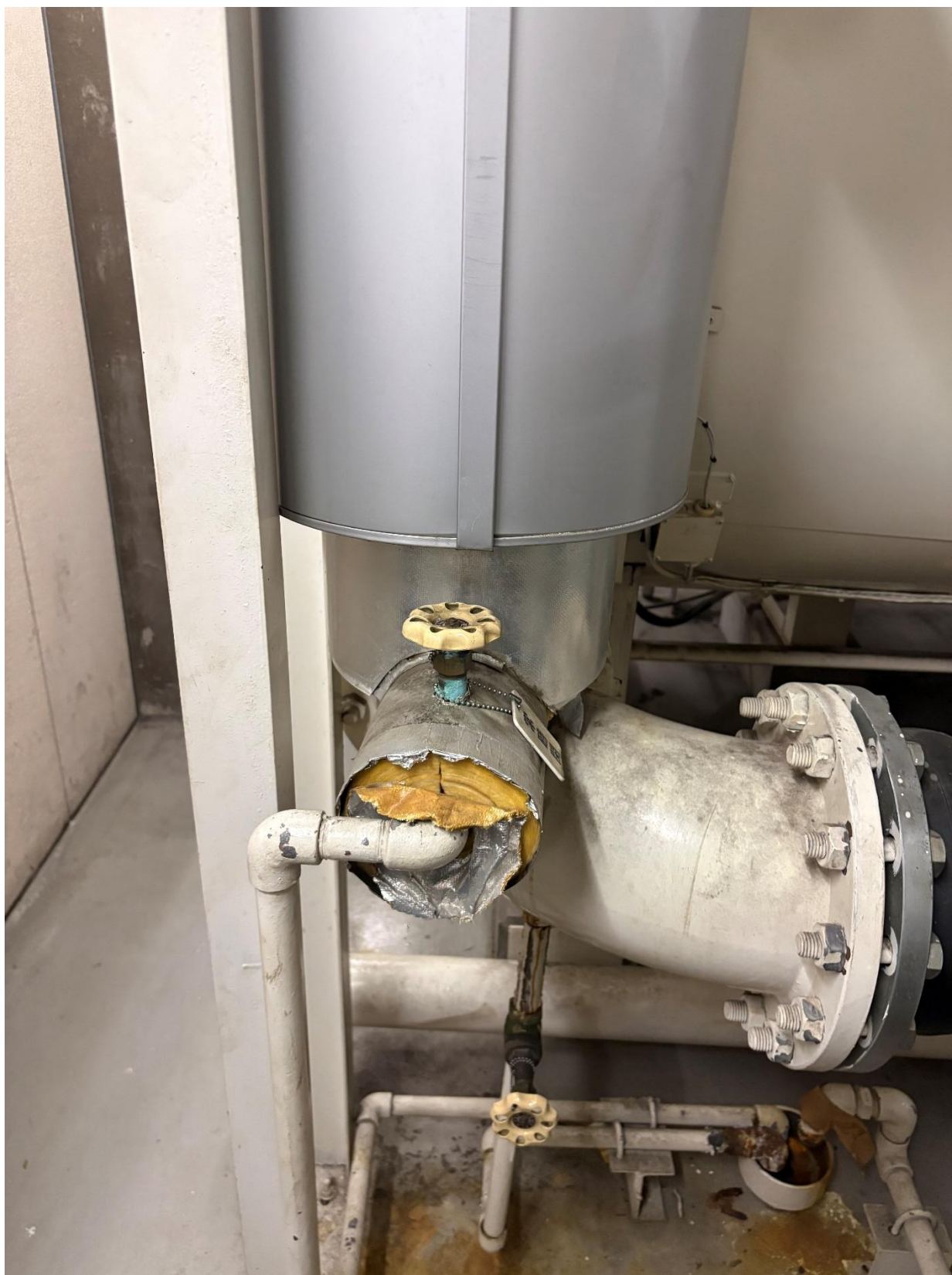
参考 2-3_冷温水管保温材 直管部
