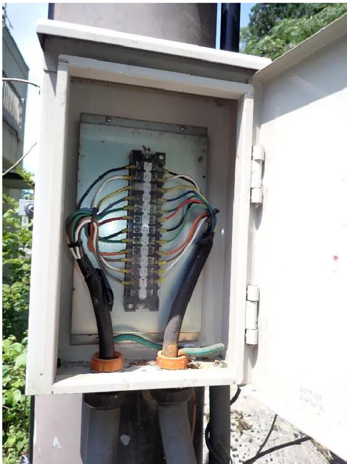
【既設方向性地絡継電器用制御ケーブル中継端子箱内部】
