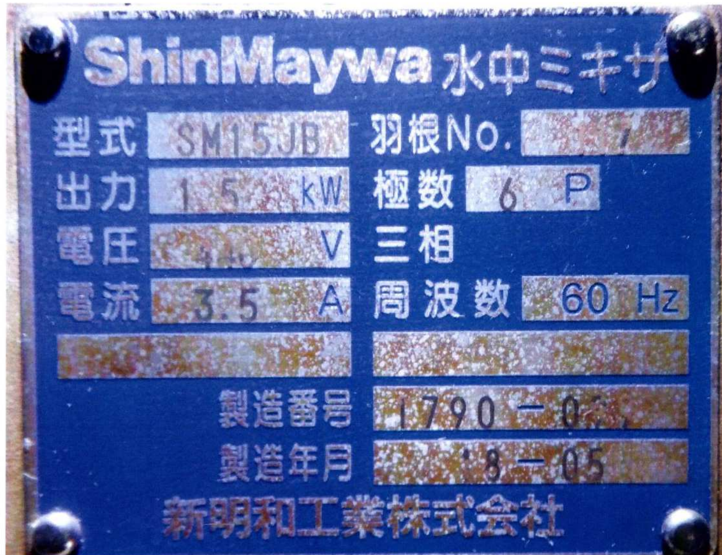
No.1膜原水槽用No.1水中攪拌装置 (1)
