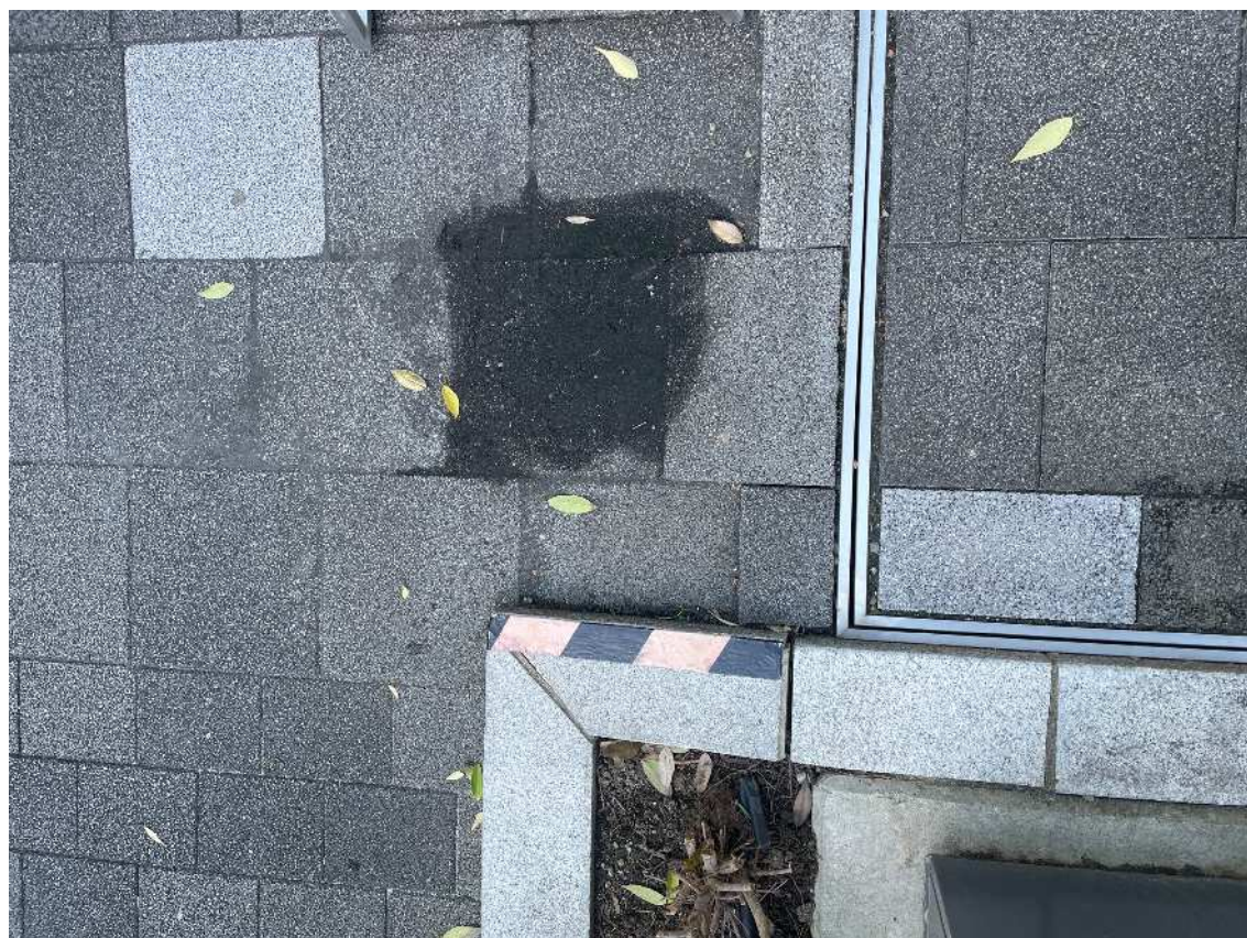
◎インターロッキング沈み箇所（拡大）
