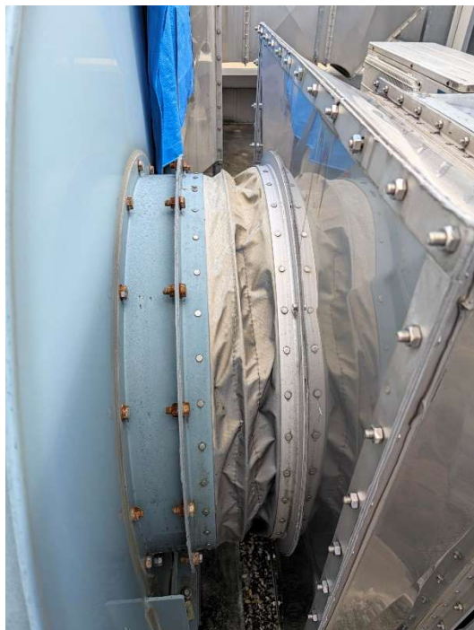
厨房用吸込側
