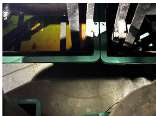
樹脂製容器(機器からの油漏れあり)
