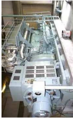
高圧自家発電設備
