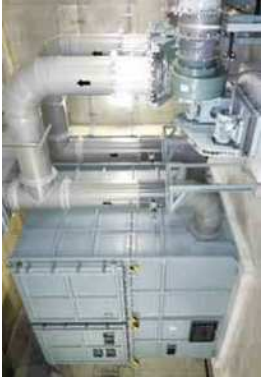
合流最初沈殿池 脱臭設備
