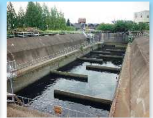
塩素接触タンク (塩素混和池)
