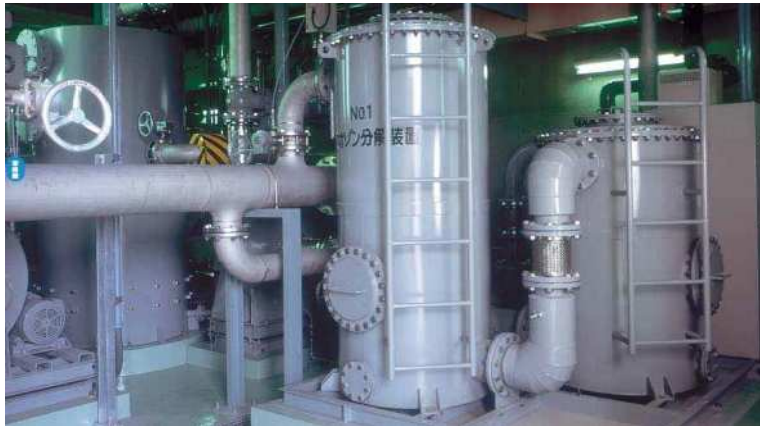
排オゾン分解装置
