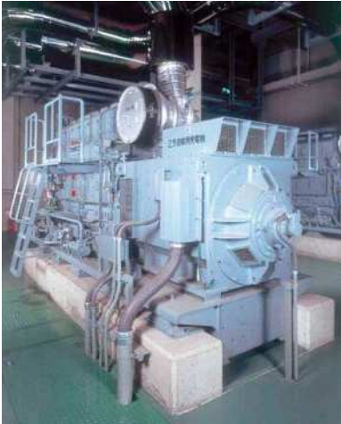
自家用発電設備
