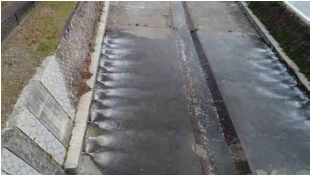
放流きょ周辺洗浄装置
