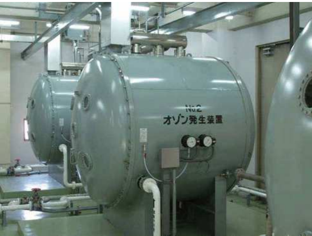
オゾン発生装置
