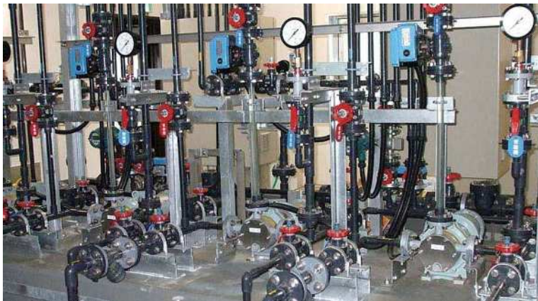
次亜塩素酸ソーダ注入ポンプ
