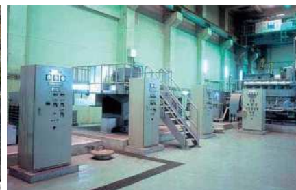
B系ポンプ場
