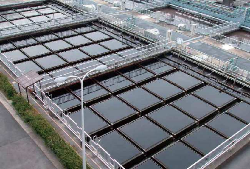
A系最終沈殿池
