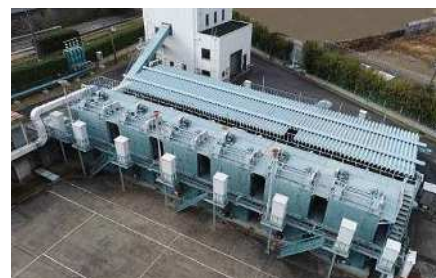
A系除じん機・沈砂池
